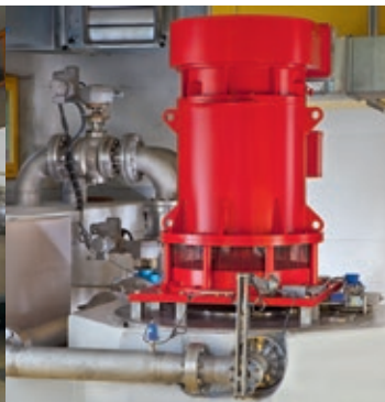
Turbine du Profray (CH), 2 injecteurs, sur les eaux usées brutes (Q = 0.100 m 3 /s, Hn = 430 m, Pm = 380 kW)
