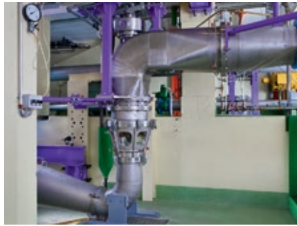
Turbine Saxo sur le stand d'essais Mhylab
