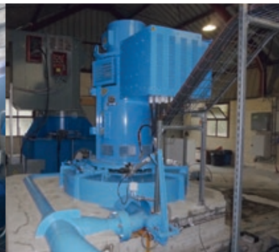
Turbine du Lauzet (F), 2 injecteurs (Q = 0.186 m 3 /s, Hn = 271 m, Pm = 431 kW)
