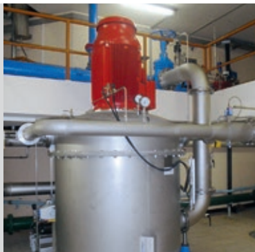
Turbine de Haute-Pierre (CH), 2 injecteurs, contre-pression, intégrée à un réseau d'eau potable (Q = 0.083 m 3 /s, Hn = 104 m, Pm = 76 kW)
