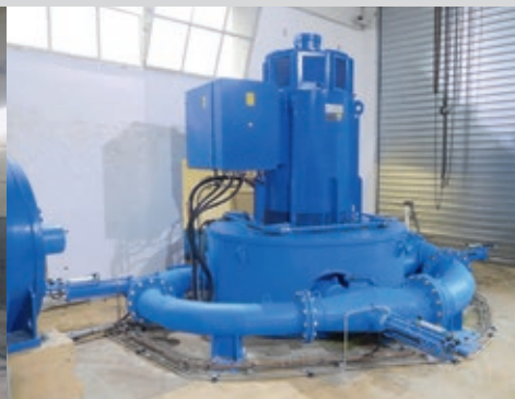
Turbine de Lafarge (F), 4 injecteurs (Q = 0.590 m 3 /s, Hn = 85 m, Pm = 435 kW)
