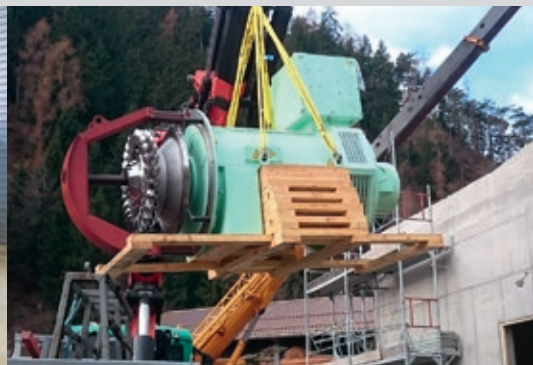
Turbine des Torrents de Verbier (CH), 4 injecteurs (Q = 0.500 m 3 /s, Hn = 475 m, Pm = 2077 kW)
