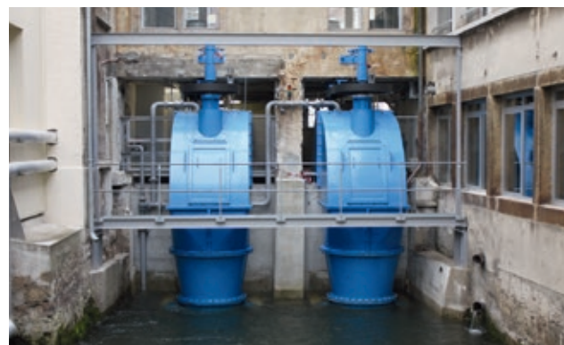
Centrale des UMV à Vallorbe (CH), turbines de type siphon (Q = 5.0 m 3 /s, Hn = 2 m, Pm = 85 kW)
